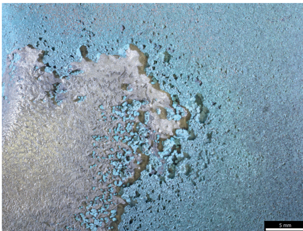
Fig. 25: Vue détaillée des dommages
