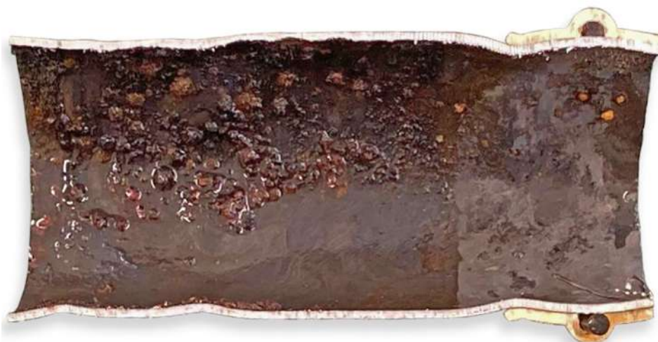
Fig. 6: Dommages causés par la corrosion par oxygène à l'intérieur d'un tuyau en acier
