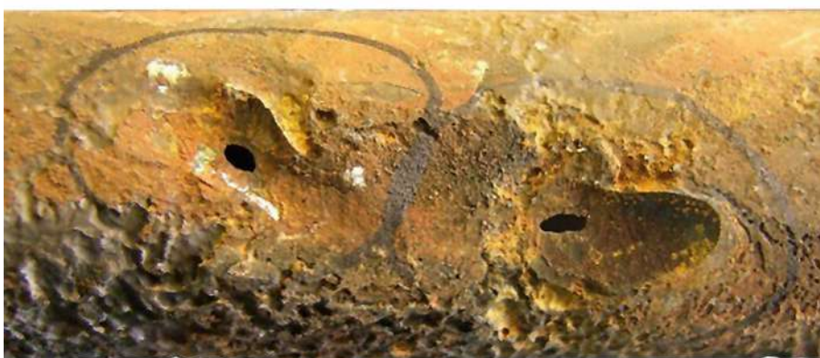
Fig. 8: Dommages par corrosion par hydrogène sur un tuyau en acier, provoqués par de l'acide sulfurique
