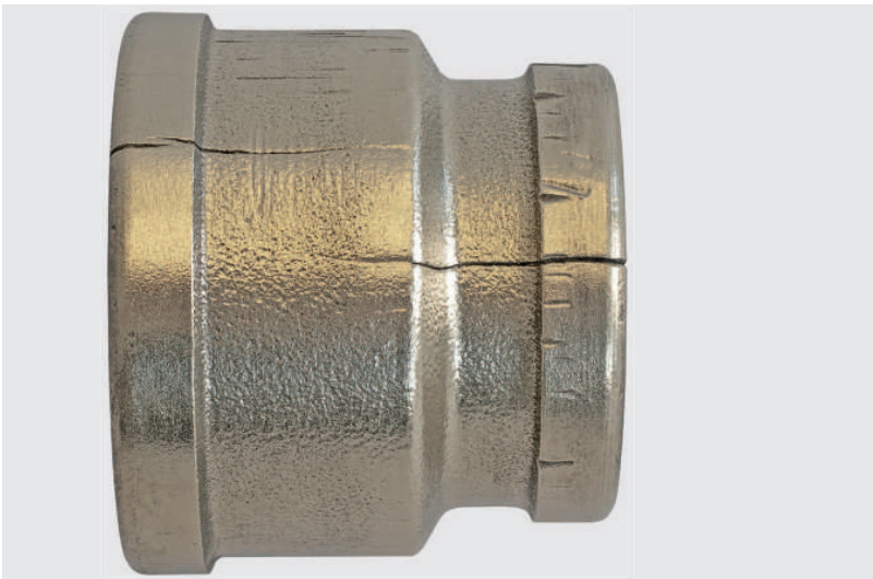
Fig. 18: Dommages que la corrosion fissurante sous tension a causés sur un raccord fileté
