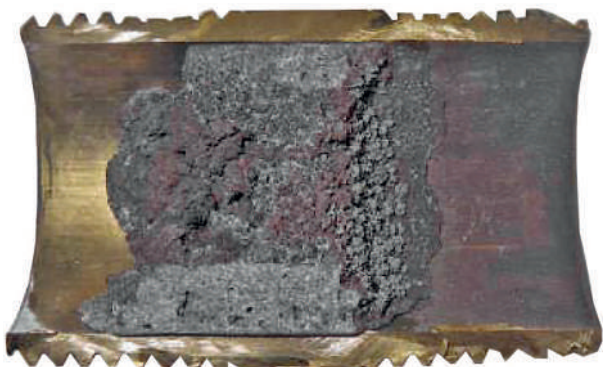
Fig. 31: Dommages par des dépôts de calcaire dans les raccords en laiton (photo: notice technique Suissetec W10019)
