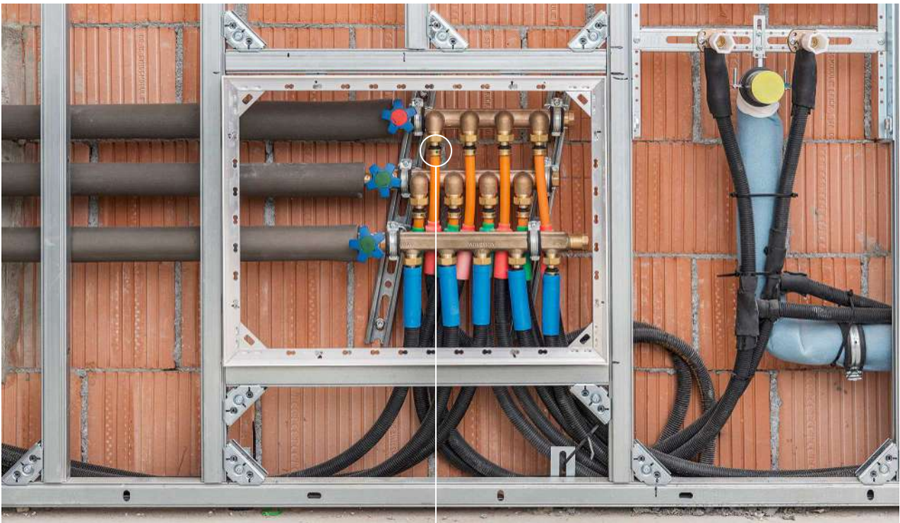
Abb. 7: Optiflex-Flowpress-Verbindungen an einer montierten Etagenverteilung
