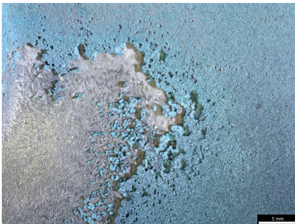
Abb. 25: Detail des Schadenbilds
