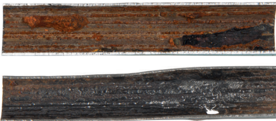
Fig. 13: Immagine del danno dovuto a corrosione superficiale su un tubo in acciaio al carbonio. Immagine sopra: vista del tubo con i prodotti della corrosione. Immagine sotto: il tubo ripulito dai prodotti della corrosione.
