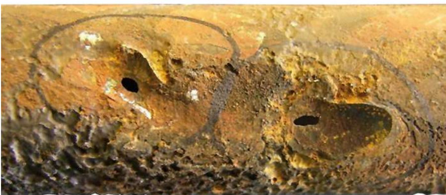
Fig. 8: Immagine del danno dovuto a corrosione da idrogeno su un tubo di acciaio causata da acido solforico.
