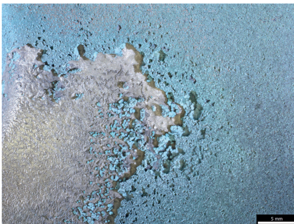
Fig. 25: Dettaglio dell'immagine del danno.
