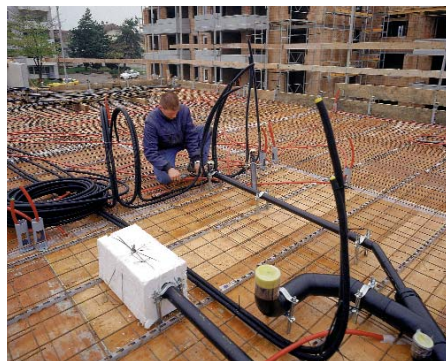
Einlegen der Optiflex-Wohnungsverteilungen.
