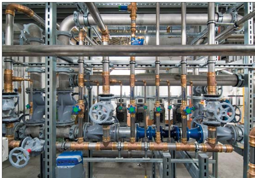
Centrale principale di distribuzione dell'acqua TZ 12
