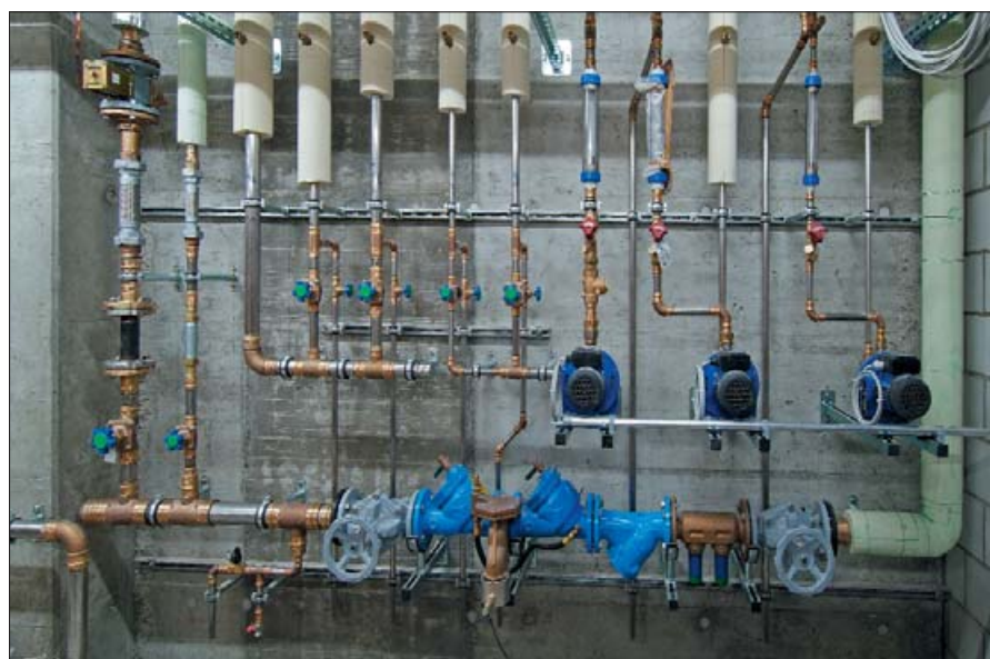
Distribuzione di acqua calda con condutture di alimentazione per gli impianti di raffreddamento del megastore Coop
