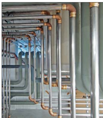
Optipress nell'area delle colonne montati della centrale principale TZ 12
