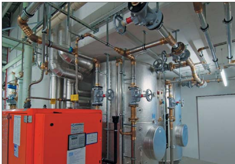
Preparazione dell'acqua calda per gli impianti sportivi, incl. la palestra
