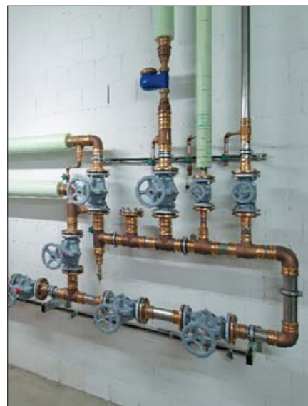
Distribution d'eau froide pour les installations sportives et la salle de sports
