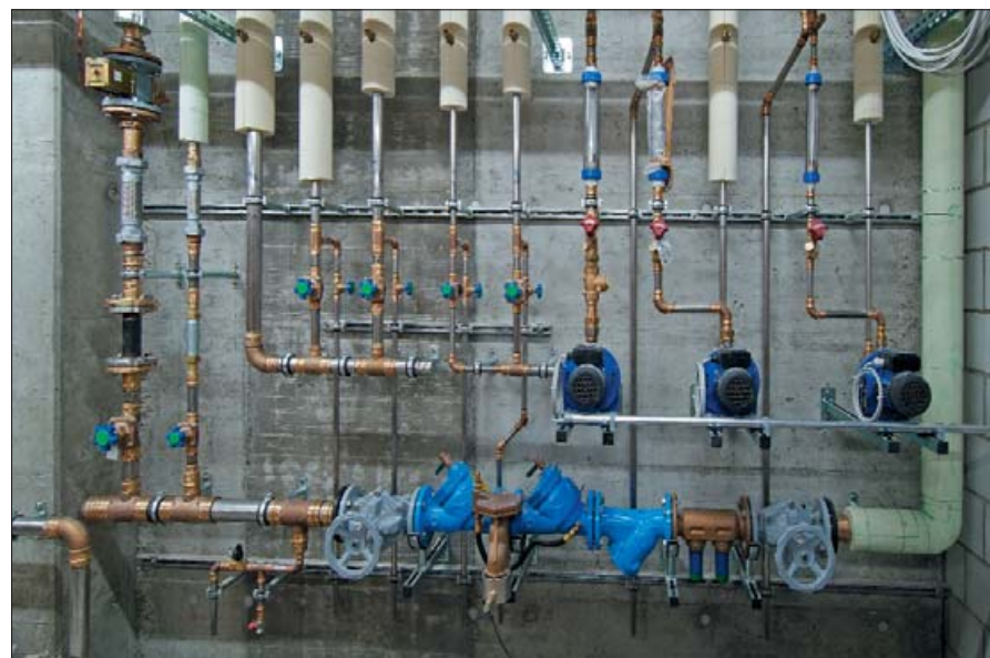
Distribution d'eau chaude avec conduites d'alimentation des unités de réfrigération pour le Mégastore Coop
