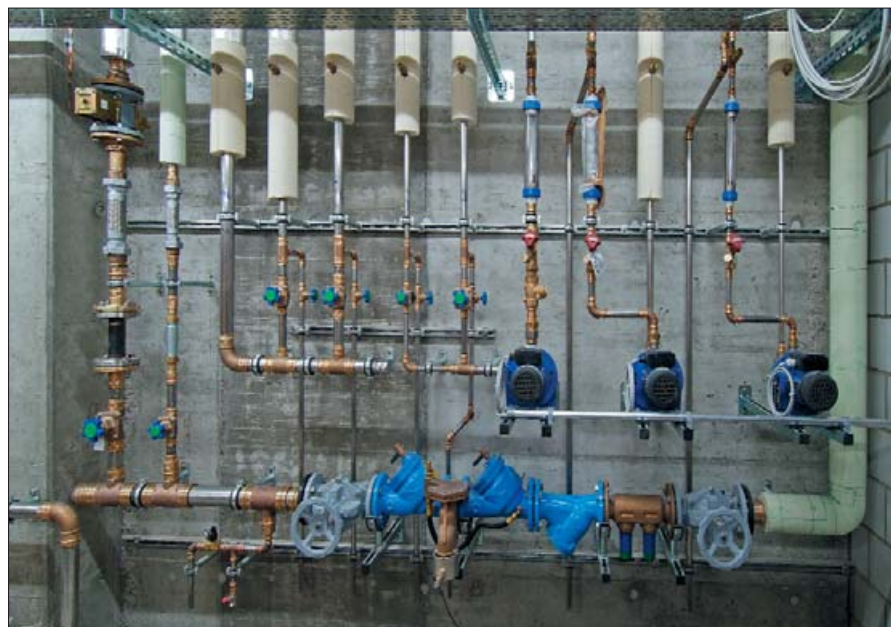
Die Warmwasserverteilung mit Ladeleitungen zu den Kälteanlagen für den Coop Megastore
