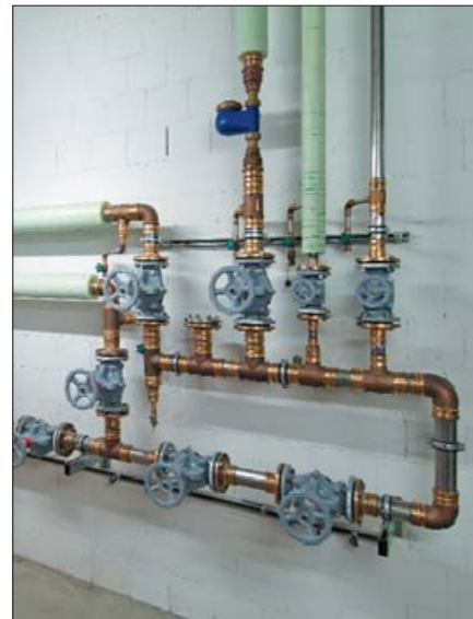
Die Kaltwasserverteilung für die Sportanlagen inkl. Turnhalle
