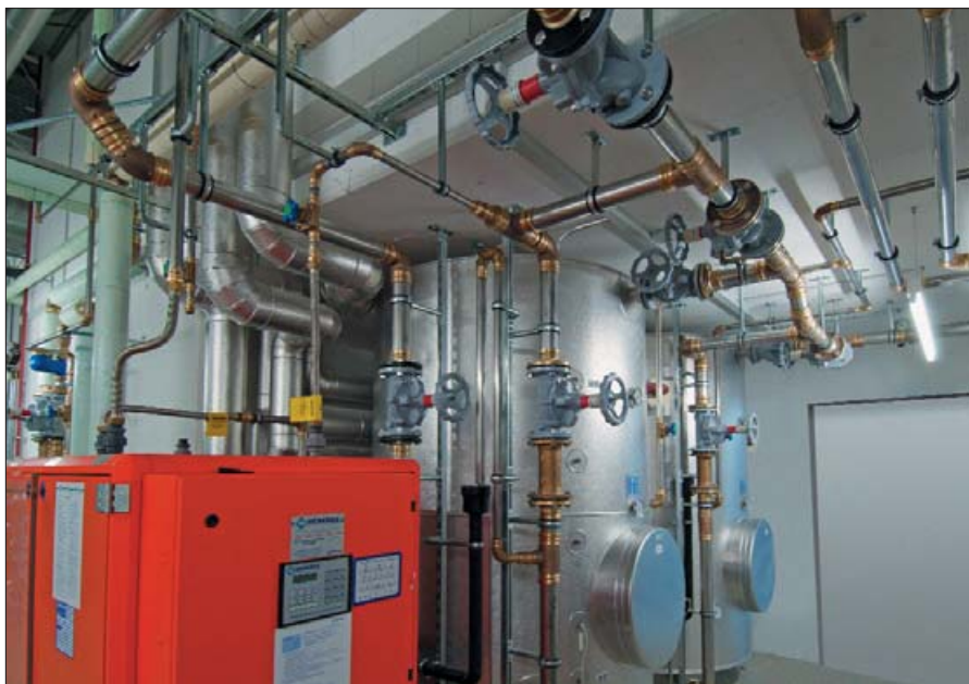
Die Warmwasseraufbereitung für die Sportanlagen inkl. Turnhalle
