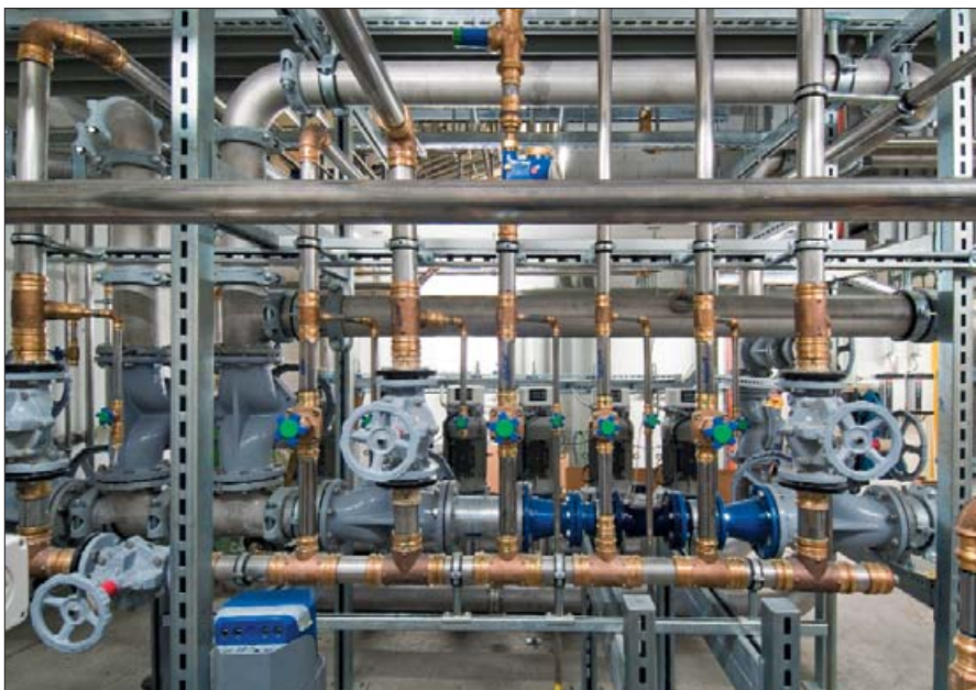
Die Wasserverteilungs-Hauptzentrale TZ 12
