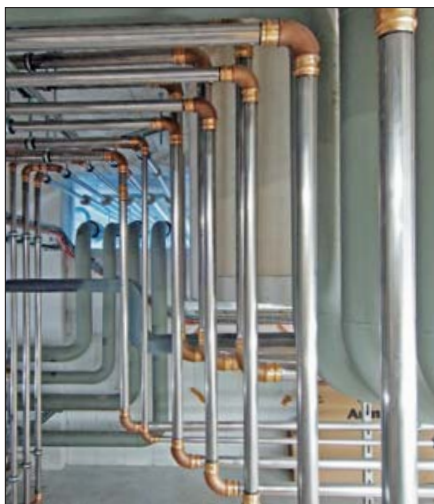
Optipress in den Steigzonen der Hauptzentrale TZ 12
