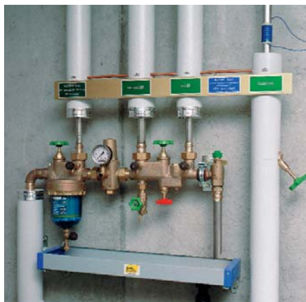
Die Hauswasserzentrale, wie sie in jedem der Einfamilienhäuser installiert ist und alle Anforderungen erfüllt.
