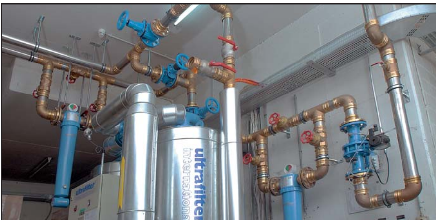
Ultrafilter- und Entfeuchtungsaggregat der Druckluftanlage mit den Ableitungen in Optipress XL Ø 89 mm.
