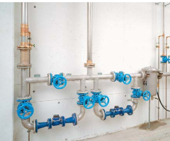
Saubere Installation für die Kaltwasserversorgung: geschweisste Verteilanlage aus Edelstahl, realisiert mit dem Installationssystem Optipress und Optipress XL.
