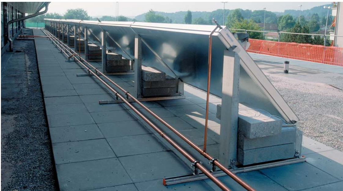
Die 15 Sonnenkollektoren mit den Kupferleitungen des Installationssystems des Cupress (vor der Isolation).
