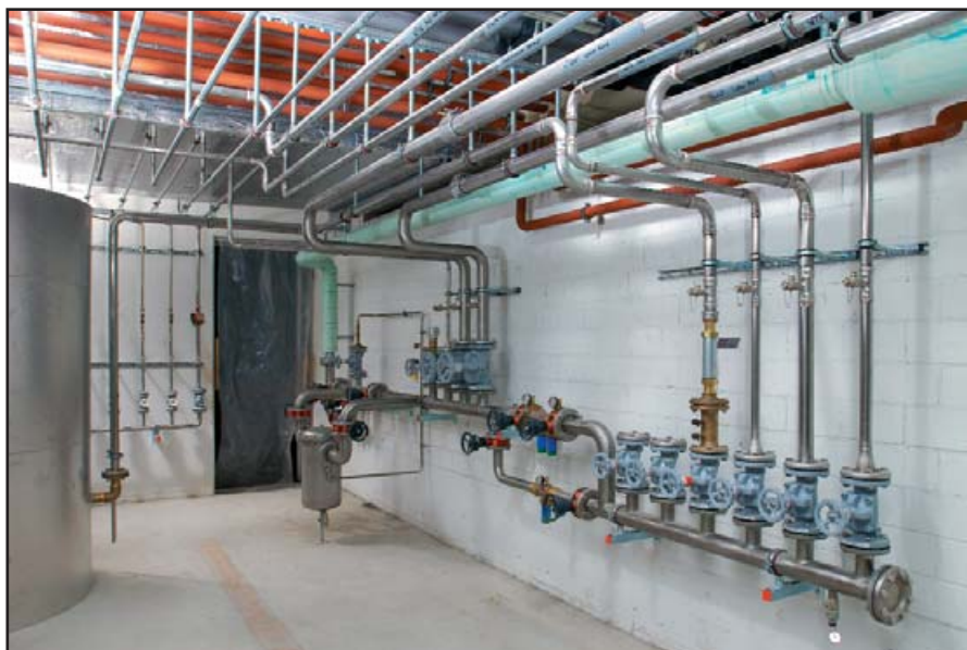
Una delle centrali per gli impianti sanitari
