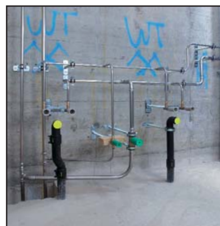
Installazione stabile fino alla captazione dell'acqua
