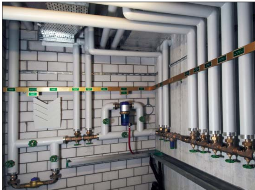
La distribuzione dell'acqua potabile in cantina.
