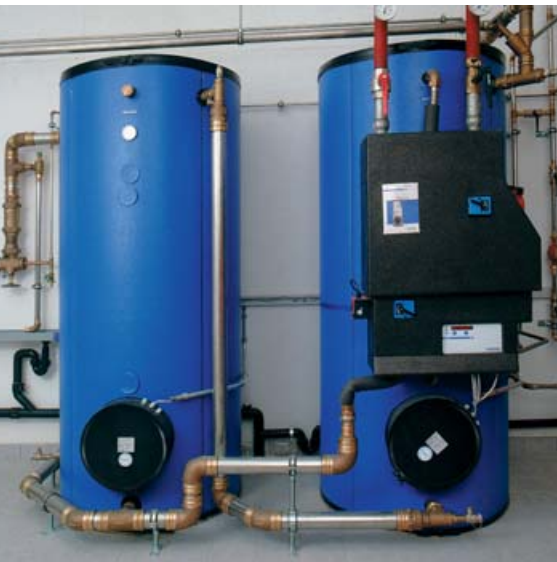
La centrale dell'acqua del complesso e gli impianti con Optipress XL.
