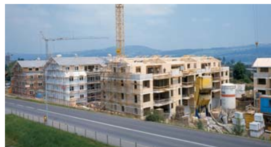
Il complesso edilizio di Hirschmatte a Oberkirch/LU: 50 appartamenti residenziali nel comprensorio economico di Sursee e Lucerna.
