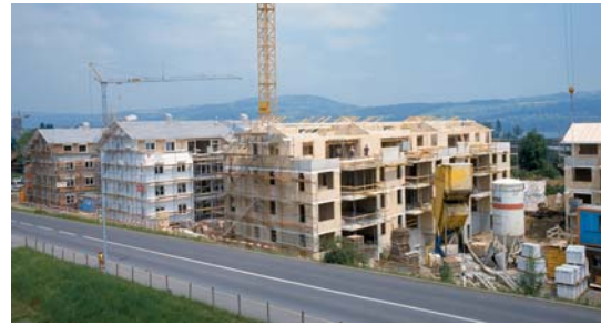
Avec la construction du complexe résidentiel Hirschmatte à Oberkirch/LU, ce sont 50 appartements de grand standing qui sont réalisés dans la zone résidentielle de Sursee et de Lucerne.
