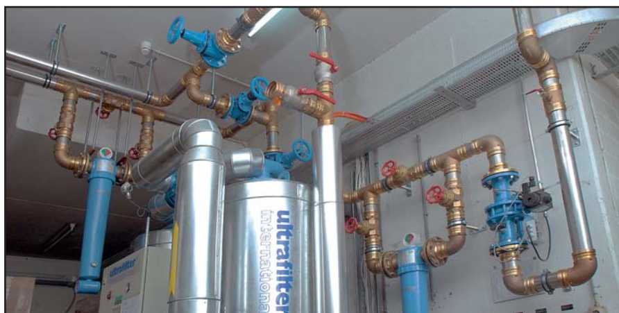
Un gruppo ultrafiltro e deumidificatore dell'impianto di aria compressa con le derivazioni in Optipress XL Ø 89 mm
