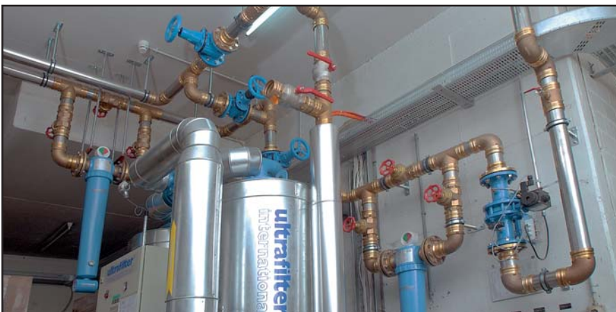
Ultrafiltres et agrégat de déshumidification de l'installation d'air comprimé raccordés avec les conduites Optipress XL Ø 89 mm
