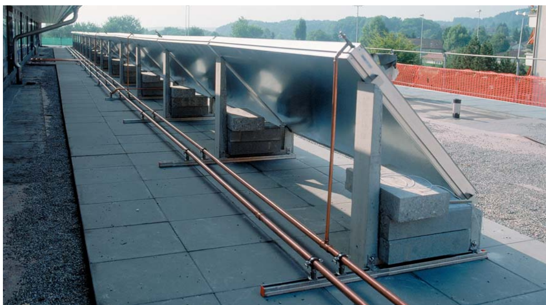
I 15 collettori solari con le condutture in rame del sistema di installazione Cupress (prima dell'isolazione).
