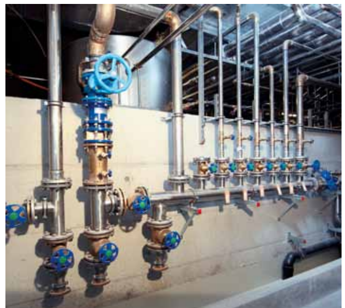
Hauswasserzentrale mit geschweissten Verteilern und neuen geflanschten Armaturen mit Easy-Top-Technologie.
