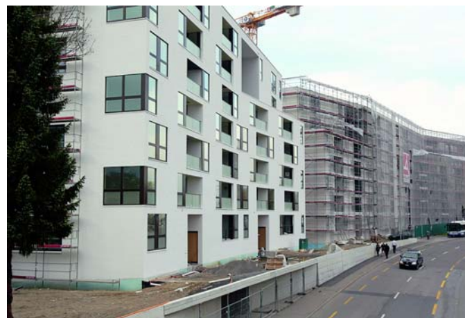
Blick auf Teile der Überbauung «Schutzengel» in Zug. Die letzten Wohnungen sollen im Sommer 2011 bezugsbereit sein. (Fotos: J. Haag)
